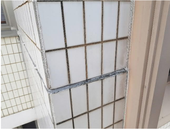
Kuva 24 Valtuustosalin saumat ovat halkeilleet.
