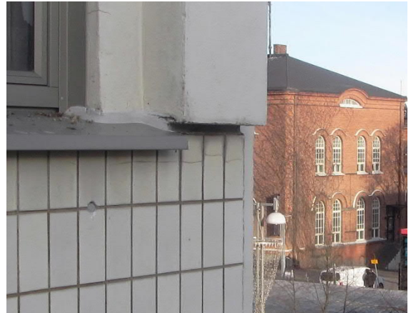
Kuva 12 Haljenneita klinkkerilaattoja eteläpäädyn julkisivulla.
