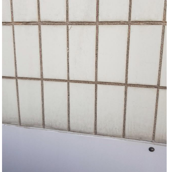
Kuva 14 Likaantumaa ikkunoiden yläpuolisten peltien yläreunalla klinkkerilaatoissa.
