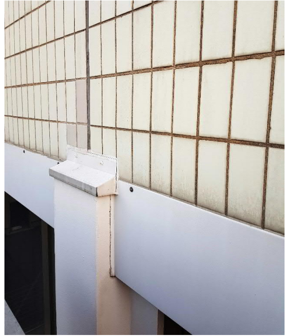
Kuva 10 Betonipilasterin ja pellityksen reunan saumat ovat halkeilleet.
