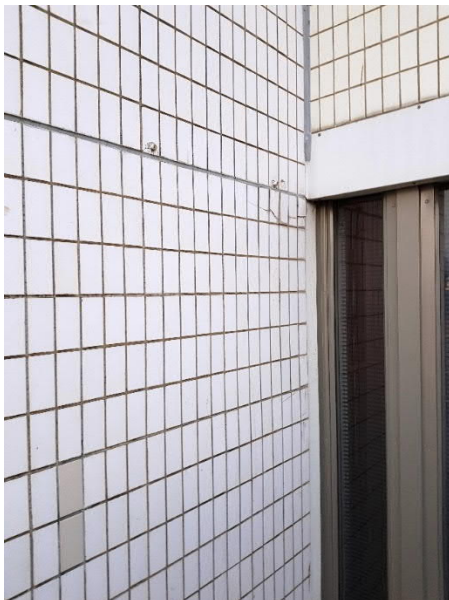
Kuva 22 Valtuustosalin julkisivussa on irtoamassa olevia klinkkerilaattoja. Yksittäisiä klinkkerilaattoja on vaihdettu.
