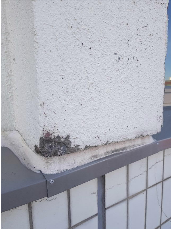
Kuva 5 Betonipilastereilla havaittiin yksittäisiä vaurioita.
