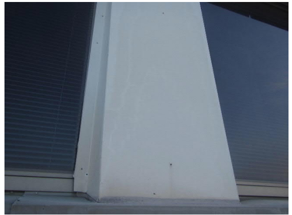
Kuva 27 Peltiverhottu ikkunaväli. Yksittäisissä pellityksissä puutteellisia kiinnityksiä
