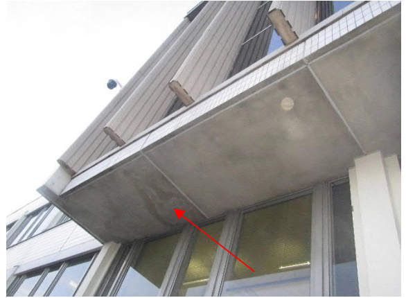
Kuva 25 Valtuustosalin ulokkeen alapintaa. Laastipinnassa epätasainen jälki. Yläpuolella peltiverhotut pilasterimaiset osat.
