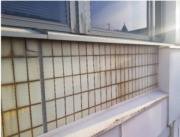
Kuva 11 Yksittäisiä haljenneita klinkkerilaattoja. Julkisivuilla havaittiin lisäksi ruostevalumajälkiä.
